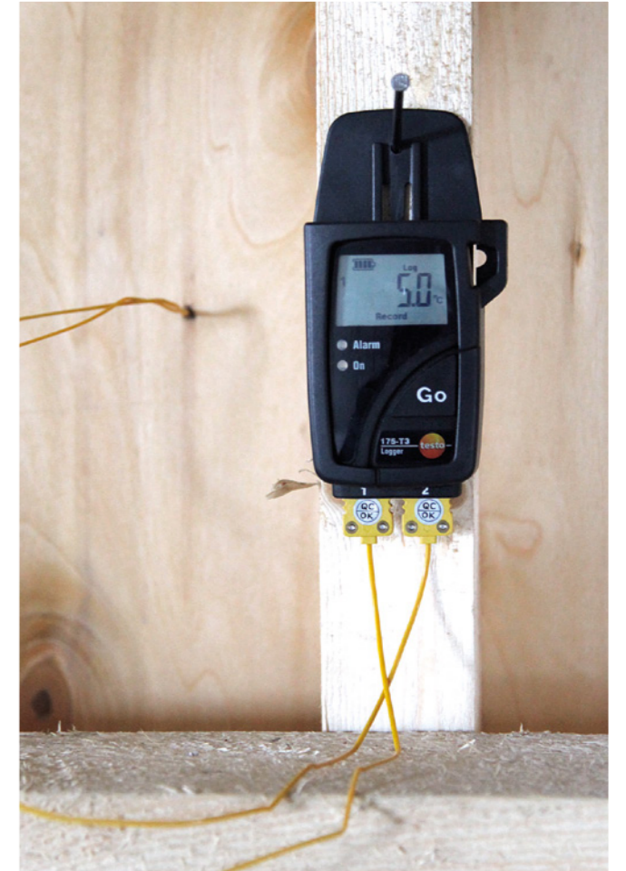
Lämpötilan mittauslaite (loggeri) edestä
