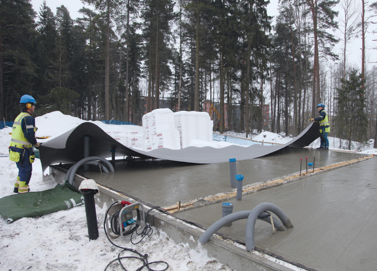
Eriste asennetaan tiiviisti valua vasten. Eristeiden asentamisen jälkeen laitetaan vielä suojapeitteet päälle.
